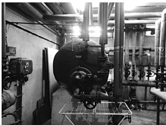
Původní technologie teplovodního potrubí v ZŠ...
